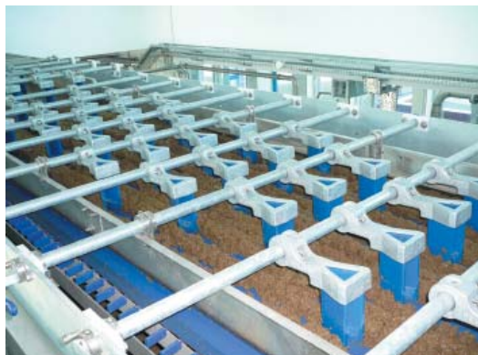
Odwadnianie osadu na prasach filtracyjnych Bellmera.
