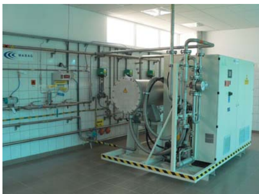
Instalacja generatorów ozonu w NBT.
