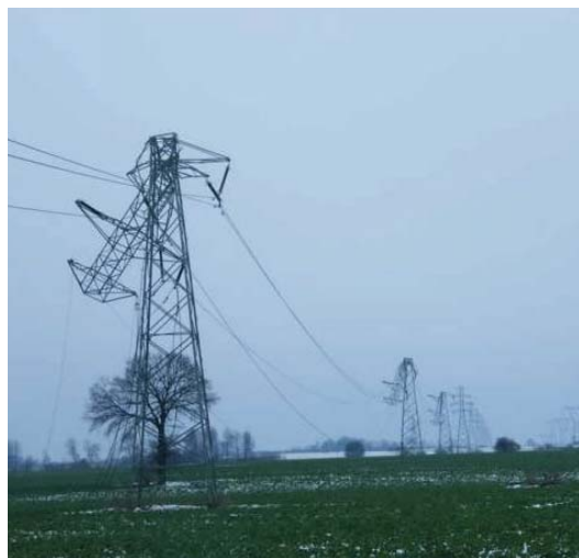
Uszkodzona sieć linii energetycznej.
